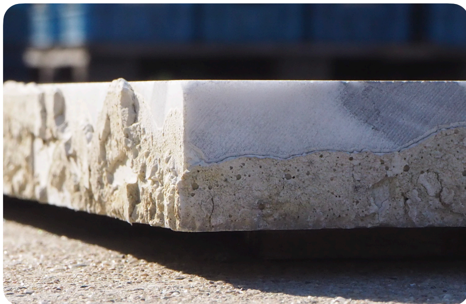
Présence de résidus de mortier
