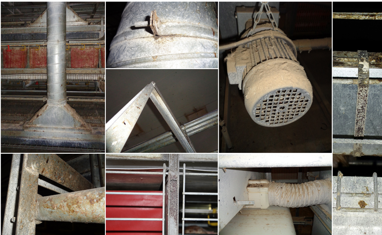
Figure 4 : Exemples de zones nécessitant un nettoyage en profondeur, tels que le système d'aération des tapis à fientes, les moteurs, les tubes, les joints, les structures de support, les attaches de câble
