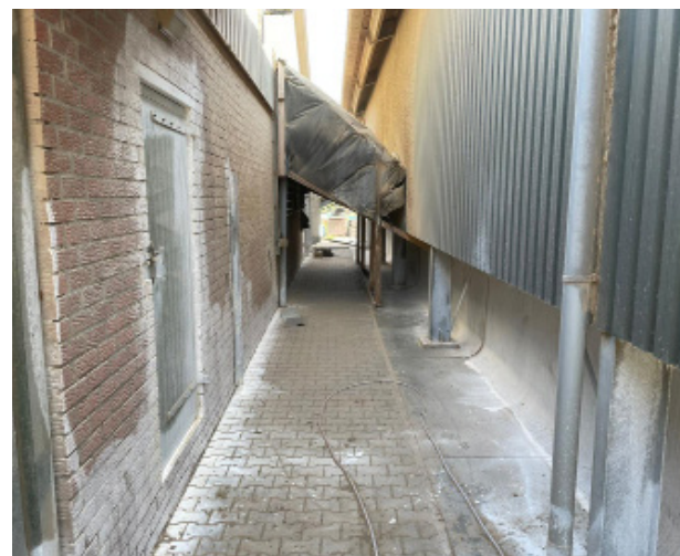
Figure 7: La silice peut être pulvérisée après l'enlèvement des fientes pour éviter les acariens de rentrer dans le bâtiment
