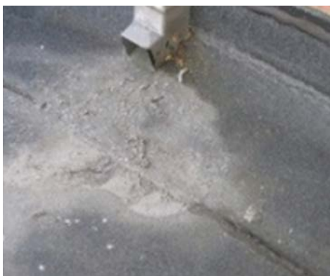
Voorbeeld van afzetting van asbesthoudend materiaal onderaan een regenpijp afkomstig van een asbesthoudende dakbedekking (fotostudiedag OVAM, 17/4/2018, presentatie Sven De Mulder "Asbestdaken veilig verwijderen",
