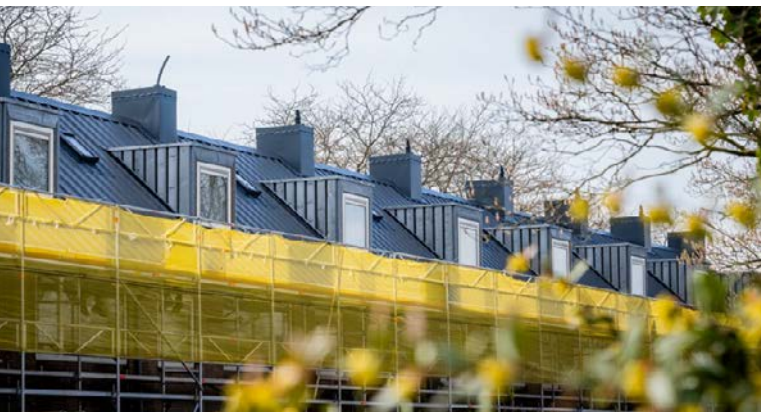
Een ander voorbeeld van creatief hergebruik : dakkapellen vervaardigd o.b.v. gerecupereerde vensters, met een bekleding in zink o.b.v. gerecupereerde dakgoten 30
