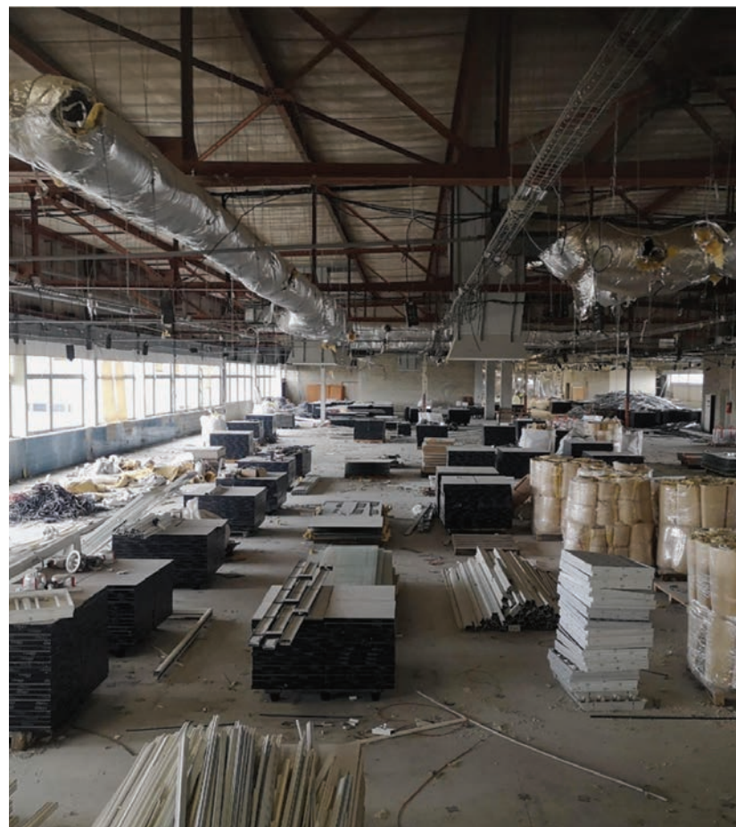
Récupération des éléments intérieurs des bureaux du Centre National des Arts Plastiques (Pantin FR ) en vue d'un réemploi hors-site. © Bellastock
